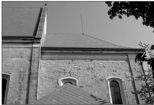
Obr. 22: Libčany (okr. Hradec Králové), kostel Nanebevzetí Panny Marie. Jižní stěna presbytáře se stopami barokního historismu ve formě rytého kvádrování (foto M. Falta 2005).
