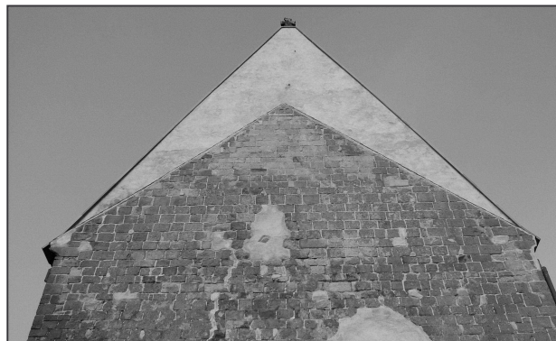
Obr. 18: Libčany (okr. Hradec Králové), kostel Nanebevzetí Panny Marie. Štítová část západního průčelí lodi se stopami po starších otvorech. Ve spodní části je patrné poškození kvádřového zdiva, které mohlo být způsobeno požárem přisazené dřevěné konstrukce (foto M. Falta 2009).
