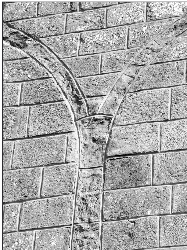
Obr. 12: Libčany (okr. Hradec Králové), kostel Nanebevzetí Panny Marie. Detail pozůstatku po slepé arkádě na jižním průčelí lodi (foto M. Falta 2006).
