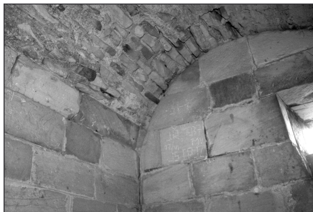
Obr. 13: Čelákovice (okr. Praha-východ), kostel Nanebevzetí Panny Marie. Detail skladby klenby kobky v předpokládaném druhém románském patře věže (foto M. Falta 2010).
